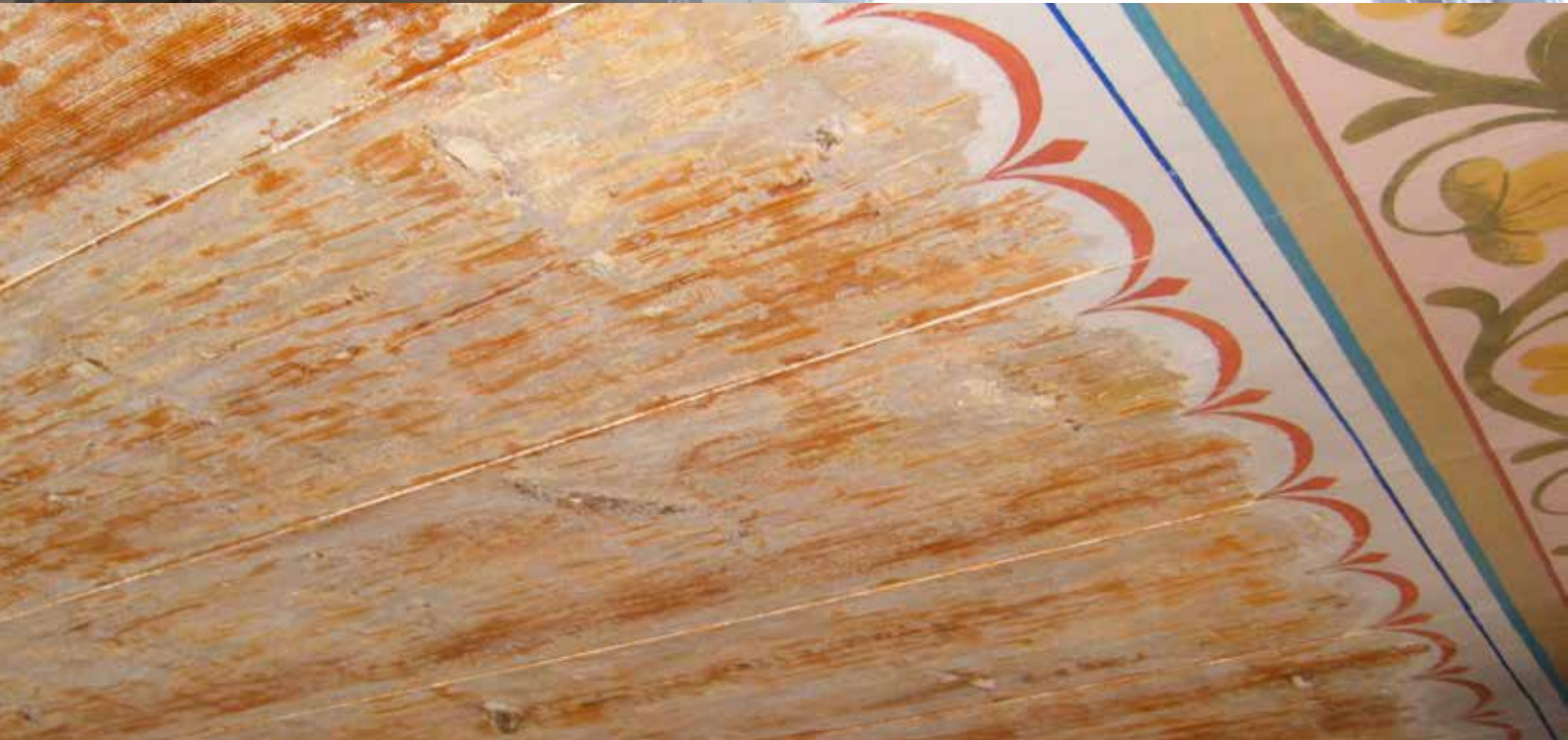
Fig. 3. Övre bild. Salstaket före ommålningen i närbild, där färgflagor är väl synliga i mittfältet. Foto: H. Bellberg. LP_2014_00090.
