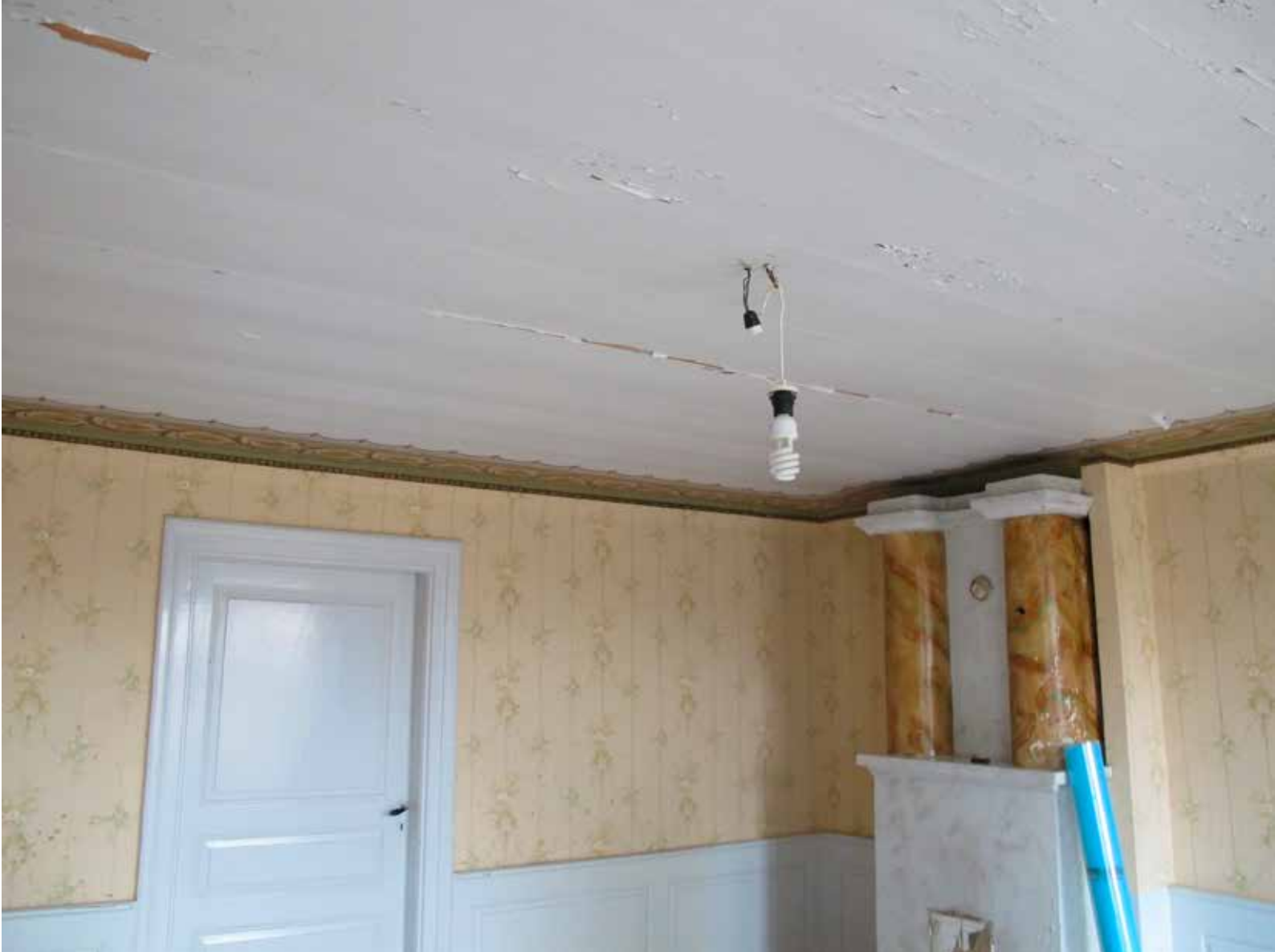
Fig. 2. Salstaket före ommålningen. I bild syns även eldstaden i form av en ornamentmålade rörspis. Foto: H. Bellberg, LP_2014_00089.
