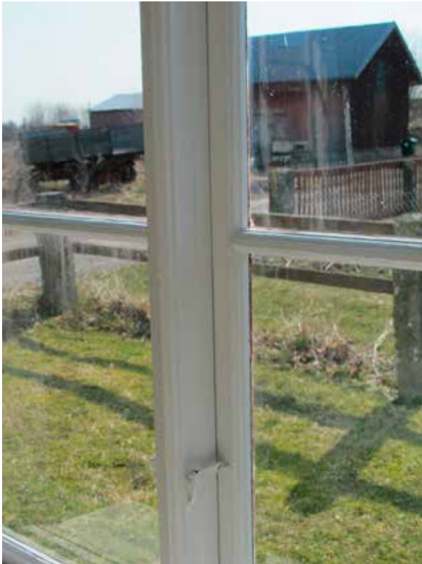
Fig. 10. Ommålad mittpost mot söder, samt tidigare ommålade ytterbågar. Fönstret, i nedervåningen, har fina gamla haspar och stjärthakar från 1800-talet. Foto: H. Bellberg. LP_2014_00096.
