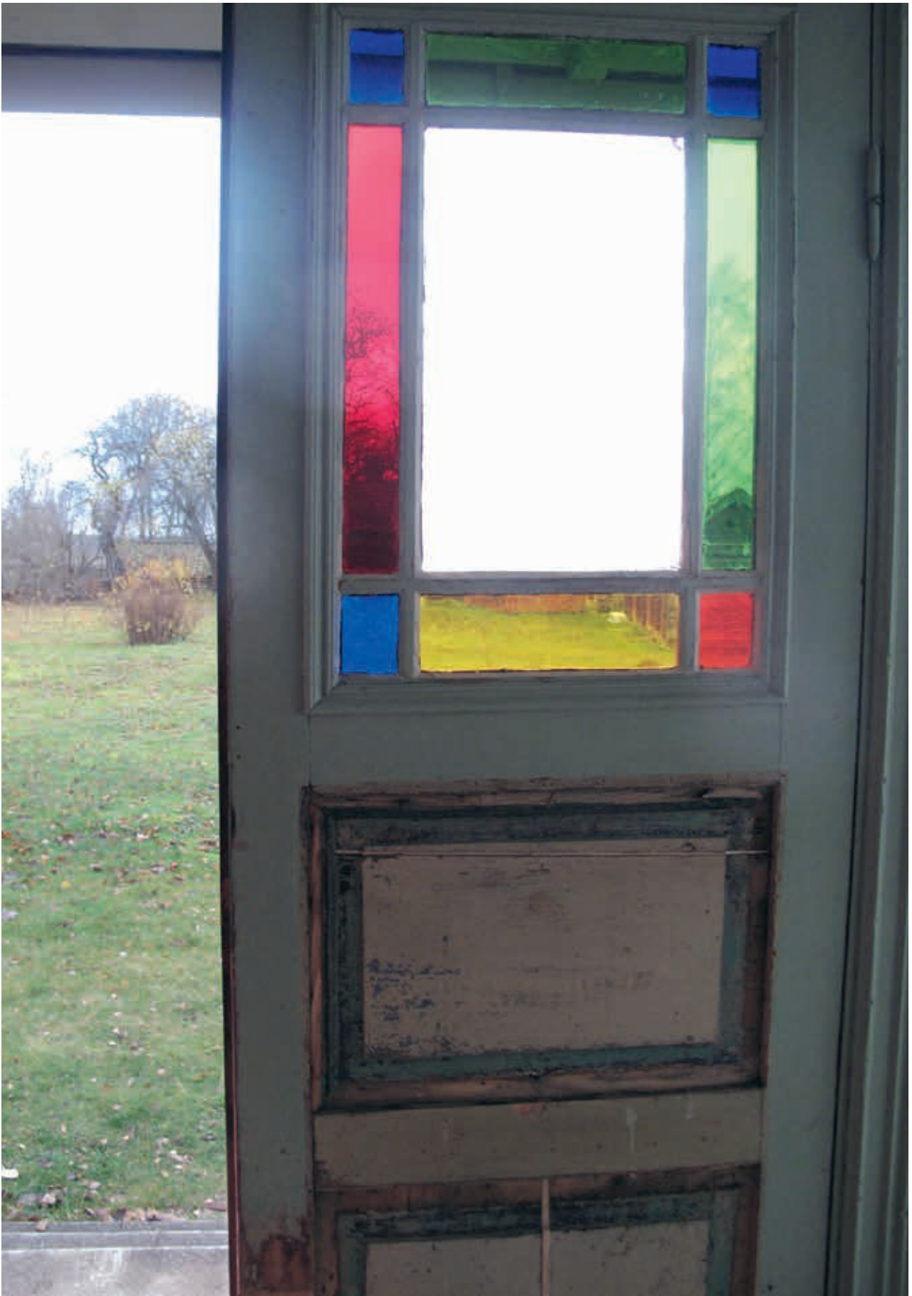
LP 201300785. Den norra dörrens insida med trälagningar där det framträtt glipor i fyllningen. Foto H. Bellberg
