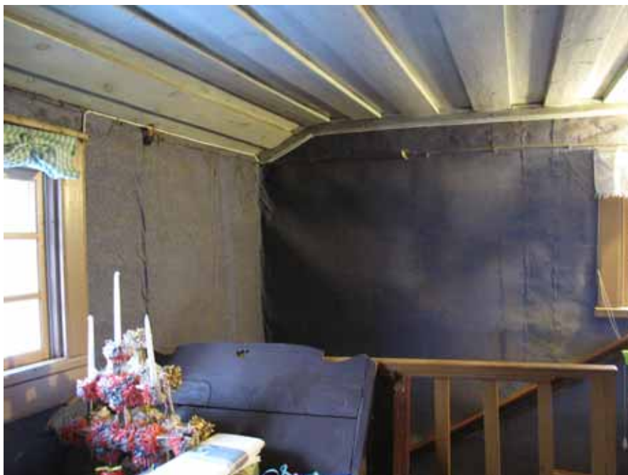
Hallen mot trappan. Den blå tapeten har fuktfläckar utmed takfoten och vertikala rinningar. Äldre elledningar har legat under den blå tapeten. Lp20100598.
