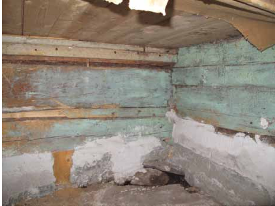
Frilagd timmerstomme under trappan, byggnadens nordöstra hörn. Lp201005585.
