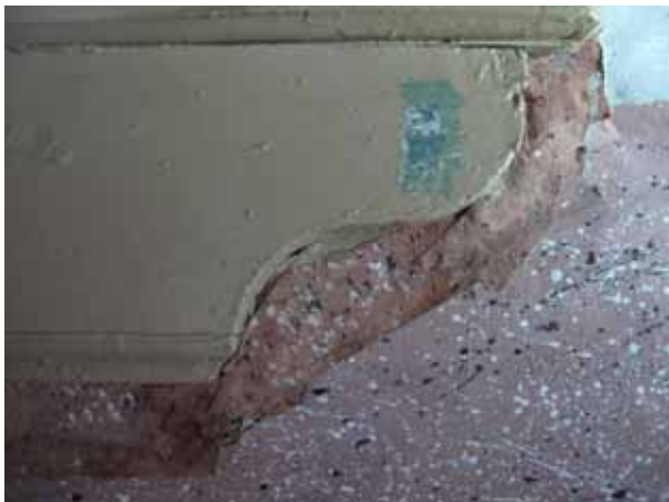
Fönster på salens södra vägg. Understycke med anslutande stänkmålade bröstning. Närmast fodret syns innmalade lagningar av pappen. På fodret syns äldre färgspår: Ljusbrun, mellangrön och den äldsta gråblå kulören, typisk för 1700-talet. Lp20100586.
