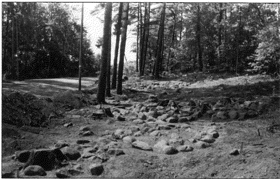
Fig 2. Del av gravfältet RAÄ 90, Botkyrka sn, sett från Ö, efter avtorvning och rensning, vid länsmuseumets undersökning 1993. Foto: Peter Bratt.
