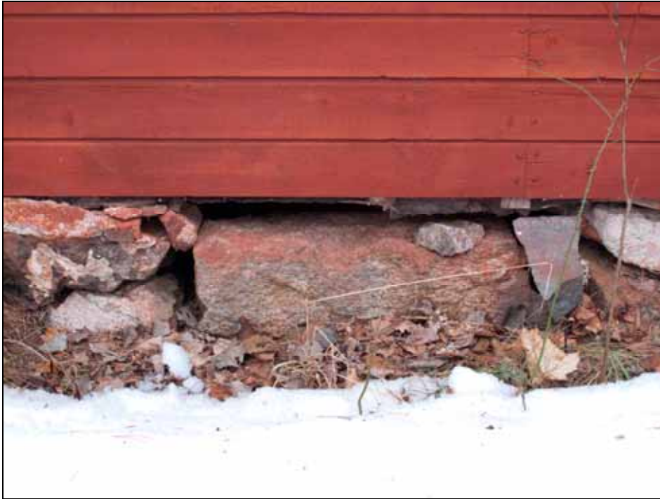
Grund av natursten. Putsen har fallit bort.
