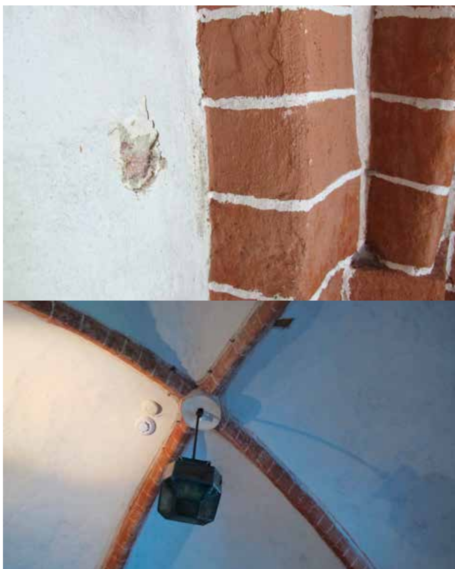
Fig.9. Övre bilden. Ett fåtal mindre skador fanns i putsen i sakristian. LP_2014_00082.
