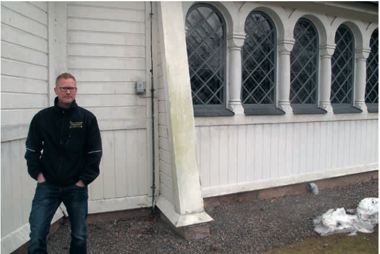
LP 201300572. Fasaden mot norr innan ommålning. I bild Linoljemålarnas Tommy Smeds. Foto H. Bellberg.
