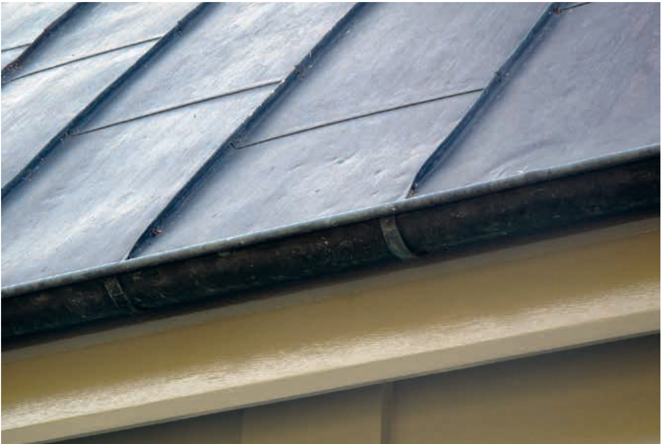
LP 201300583. Små skador på taket mot norr. Foto H. Bellberg.
