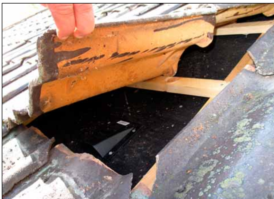
Lufttossar har fällts in i takpanelen. Foto: Gunilla Nilsson.
