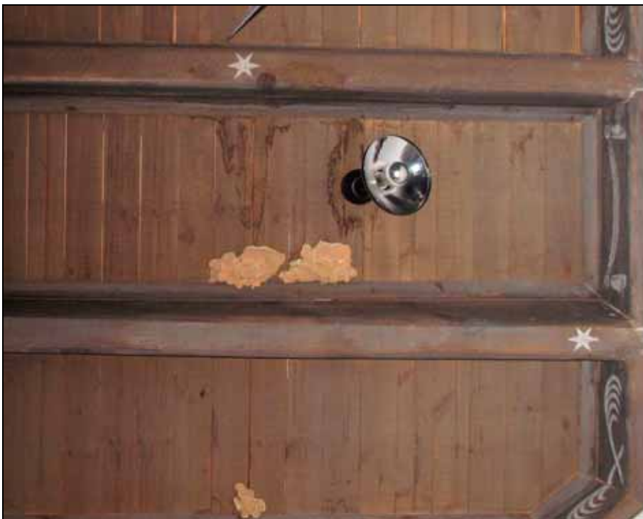
Fuktskada och svampangrepp av källarkantarell i kapellets innertak. Foto: Gunilla Nilsson, november 2009.
