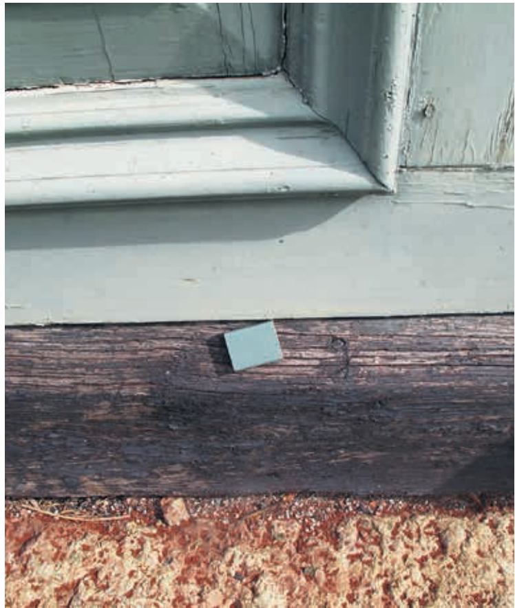
LP 201300547. Färgprov till dörren på sydsidan, där färgen blivit blekt.
