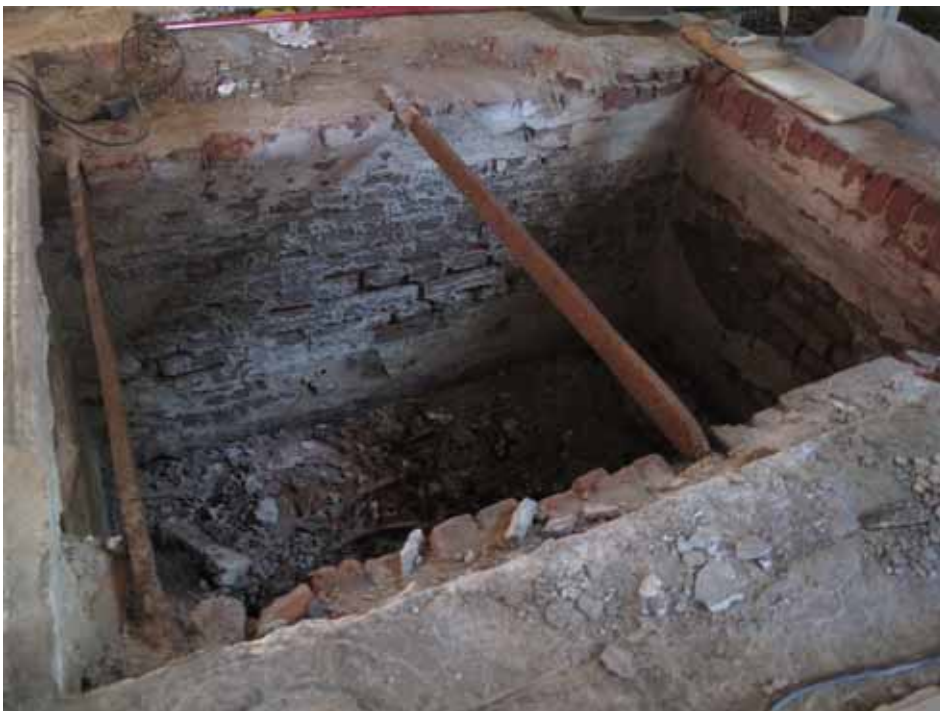
Gravrummet från nordväst. Järnstängerna som bar upp gravhällen var mycket korroderade i ändarna.
