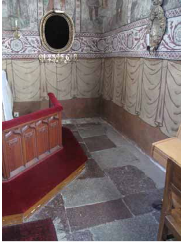
Korets södra sida före åtgärd. Kalkstensplattorna lutade på grund av lokal sättning i underliggande golvmaterial.
