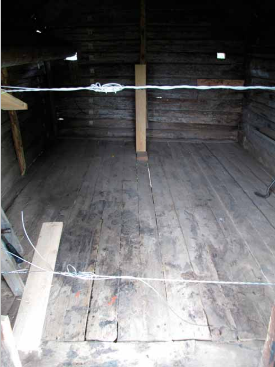
Sjöbodens interiör innan renovering. Här syns de tillfälliga uppstagningar som gjorts tidigare samt märkningen av timmerstommen innan nedplockning. Foto Albin Uller 2011. Lp20111698.
