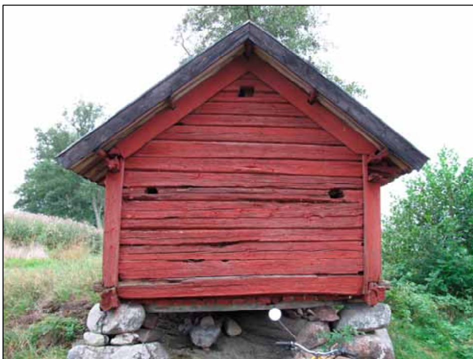
Den bakre gaveln innan renoveringen. Här syns tydligt de kvadratiska hålen samt golvet med dess bjälklag. Foto Albin Uller 2011. Lp20111694.
