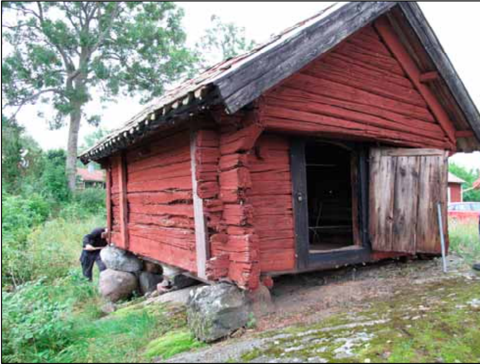
Sjöbodens entréside innan renovering. Här syns skallarnas och fasadernas skador tydligt. Foto Albin Uller 2011. Lp20111701.
