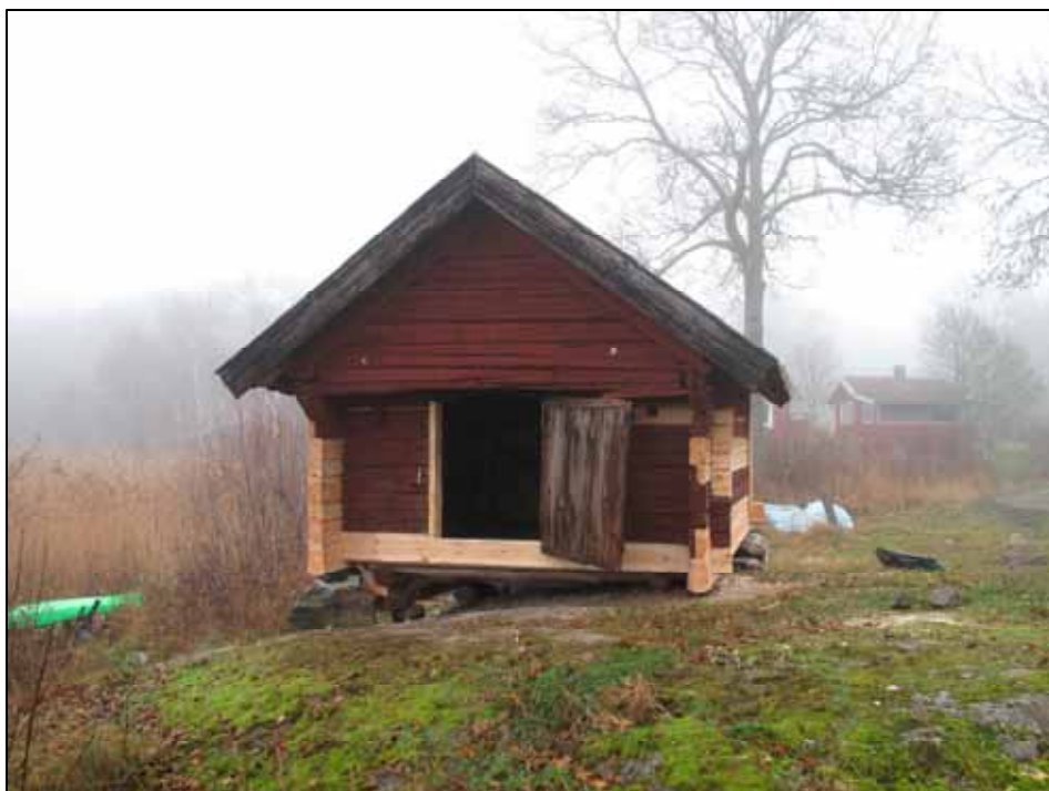
Sjöbodens entrésida efter renoveringen. Här syns de lagade knutskallarna och ett av de nya dörrsvärden. Foto Albin Uller 2011. Lp20111707.
