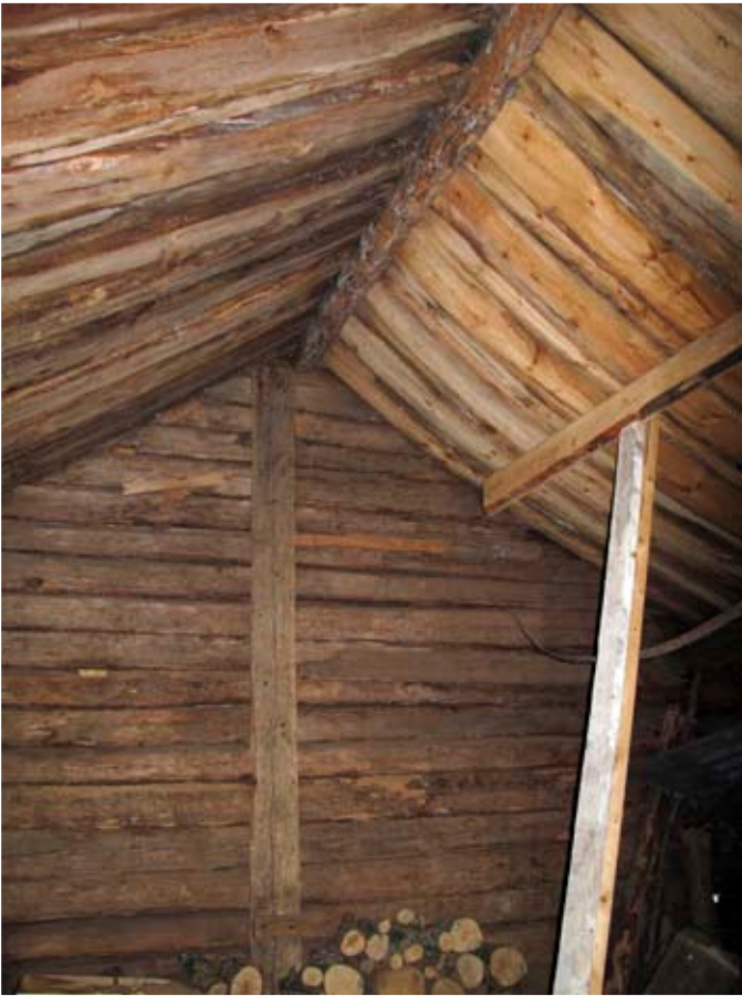
Det gamla taket med stötta. Foto Albin Uller Lp20111251.
