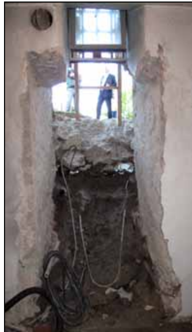
Murgenombrott i källarmur i samma läge som öppning från 1902. Bildnr: lp20200224
