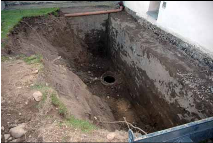
Schackning för ingång till sakristians källare i öster. Mot källarens grundmur har gjutits en kraftig betonggrund. Den har kommit till på 1930-talet eller ev. senare. I botten av schaktet syns en dagvattenbrunn. Jordlagren var omrörda efter tidigare grävningsarbete. Bildnr: lp20100222. Foto: M. Boije, 2009
