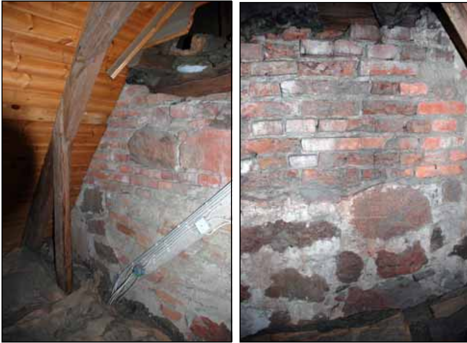
Sydöstra hörnet av mur mot långhuset. Sydvästra delen av mur mot långhuset. Bildnr: lp20100217 Bildnr: lp20100218
