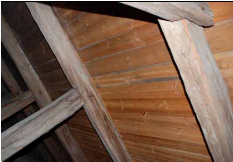
Takpanelen är troligen samtida med den senaste omläggningen av koppartaket under 1900-talet. Bildnr: lp20100219
