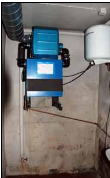
Fuktproblem före ombyggnad. Bildnr: lp20100204
