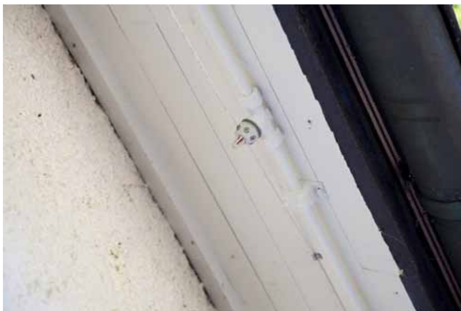
Utvändig sprinkler löper längs med takfoten. Rördragingar målades in. Fotograf Elisabeth Boogh 2011.
