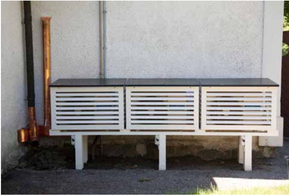
Luftvärmepumparna bakom specialbyggda träskydd. Den anslutande rördragningen kläddes med metallrör respektive kopparplåt i anslutning till stupröret.
