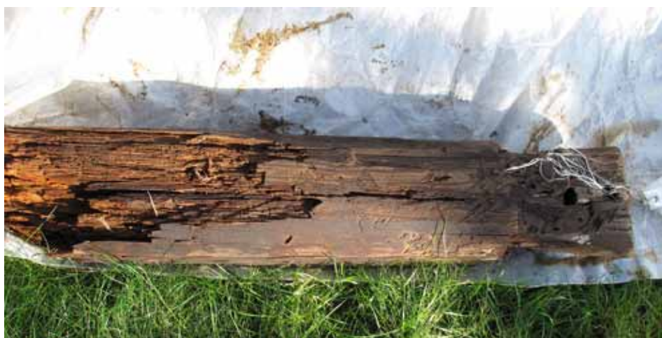
Rester av rötskadad balk som ersatts med nytt virke. Bildnr: lp20100244
