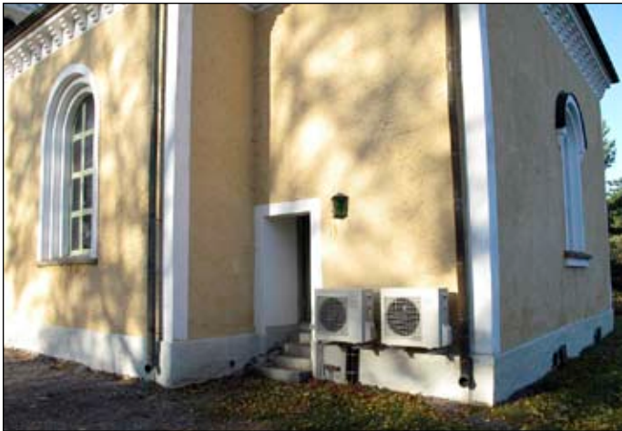
Värmepumparnas placering på sakristians södra vägg. Foto Albin Uller Lp20111299.
