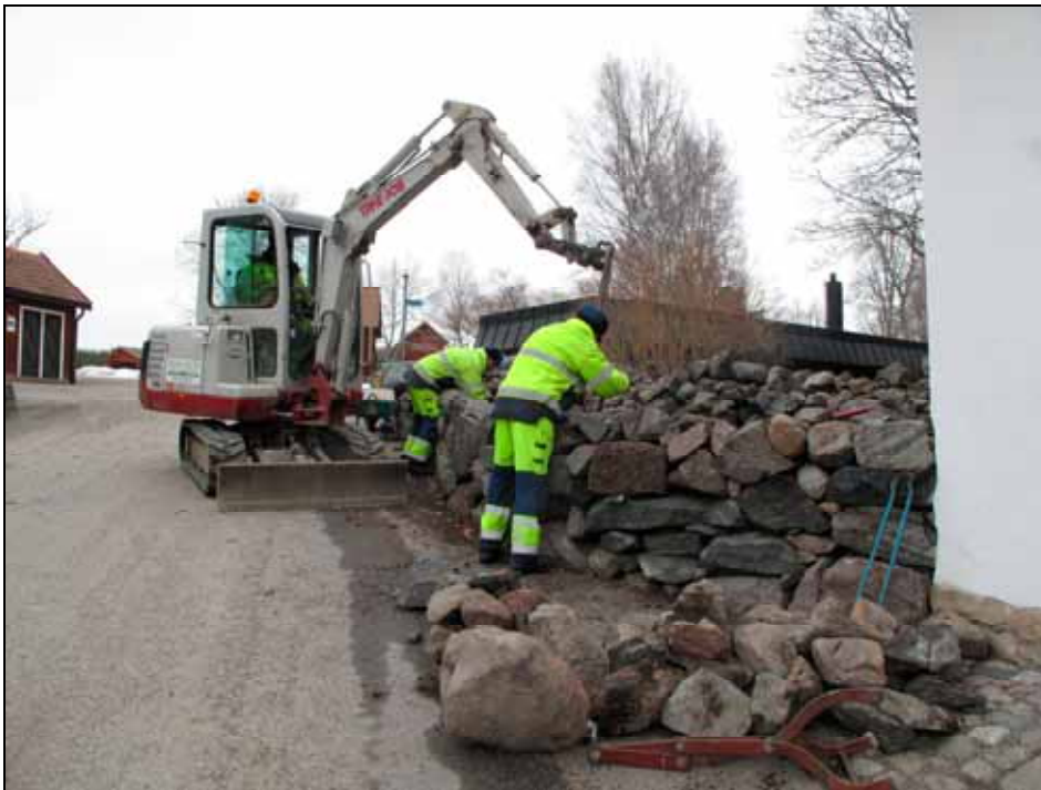
Den första delsträckan som lades om utgjordes av kyrkogårdsmurens västra del norr om stigluckan.
