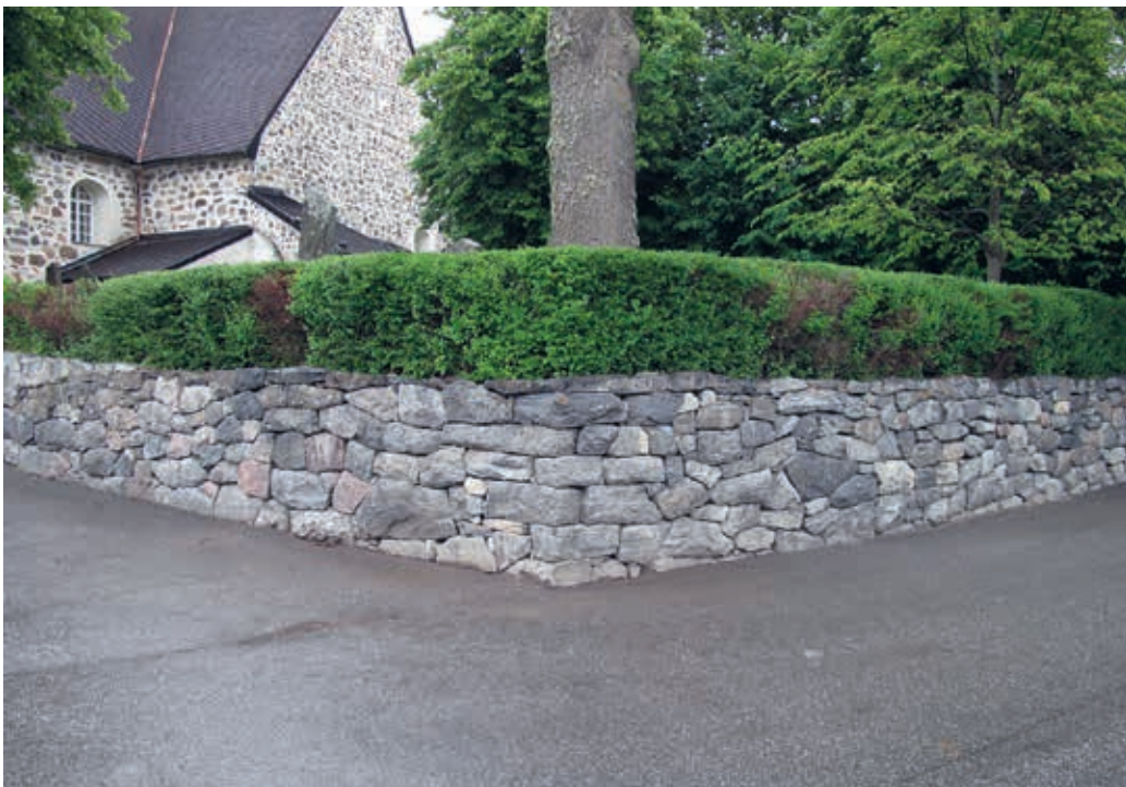
Lp201300477 Bogårdsmurens sydvästra hörn efter omläggning pga föreliggande rasrisk. Foto Albin Uller 2013.
