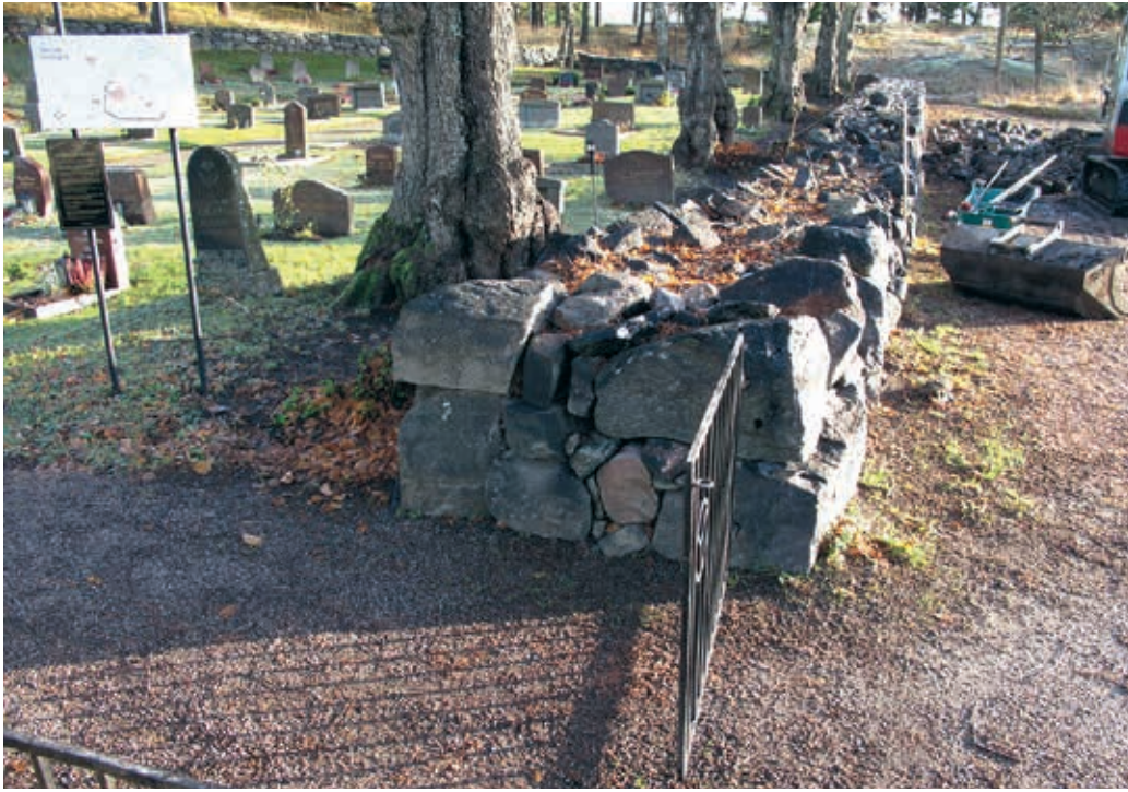
Lp201300374. Delsträcka G-H med murens avslutning med grind innan omläggning. Foto Albin Uller 2012.
