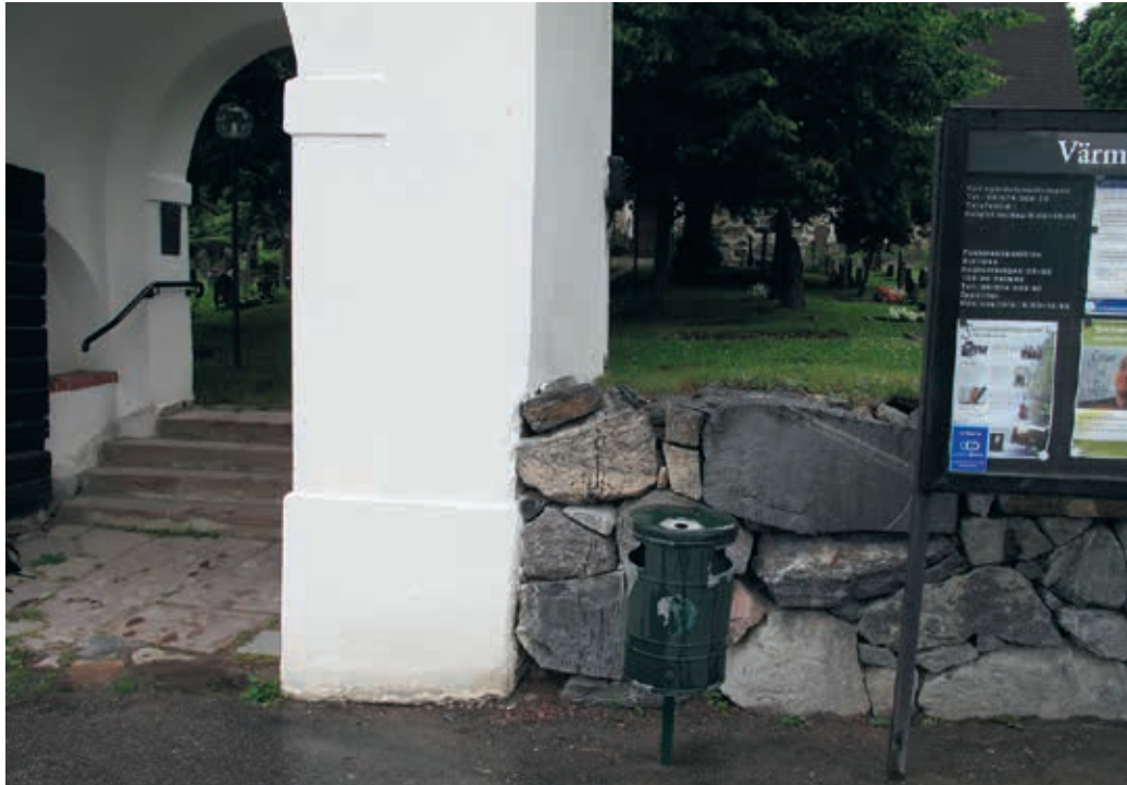
Lp201300465. Delsträcka I-J. Murens anslutning till den södra stigluckan efter omläggning. Foto Albin Uller 2013.
