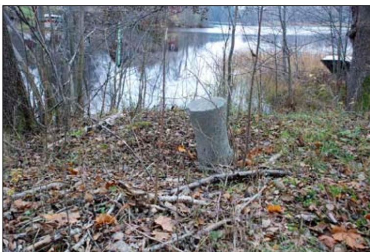
Fig 33. Objekt 4. Pollare som står snett i marken sannolikt pga sättning. Foto: G. Werthwein.
