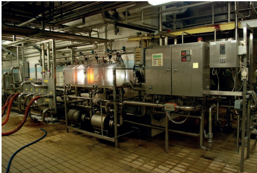
Blandbocken (till vänster i bild) sköts från en styrenhet (till höger). I fyra behållare av glas och metall cirkulerar öl och vatten. Foto LKU.
