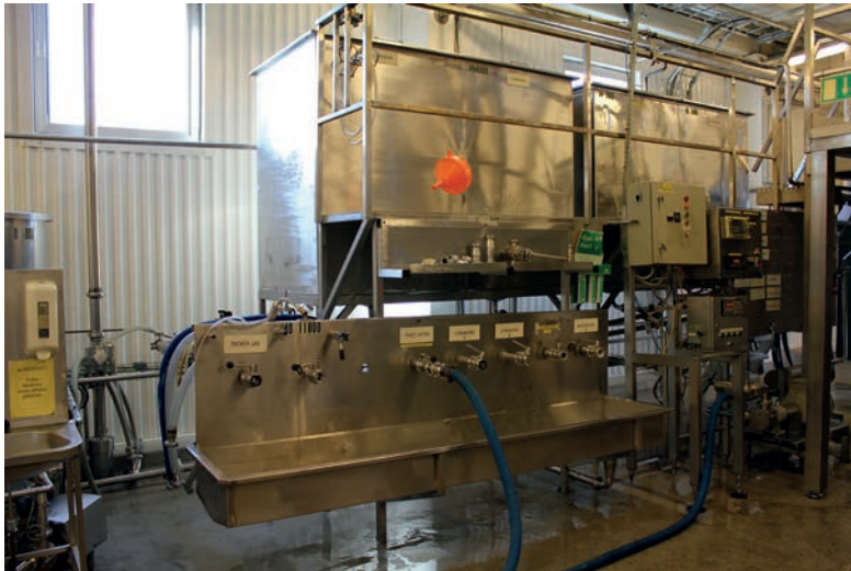
Blandningspanel för vatten, sockerlag, citronsyra och natriumbensoat där slangarna kopplas till respektive uttag. Den vänstra rektangulära tanken som syns ovanför blandningspanelen innehåller citronsyra och den högra natriumbensoat. Foto HL.
