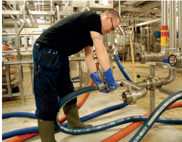
I anslutning till trycktanksrummet finns en liten manöveravdelning. På bilden kopplar Benny Olsson avluftat vatten för att trycka ut öl från ledningar upp till tappmaskinen. Foto LKU.
