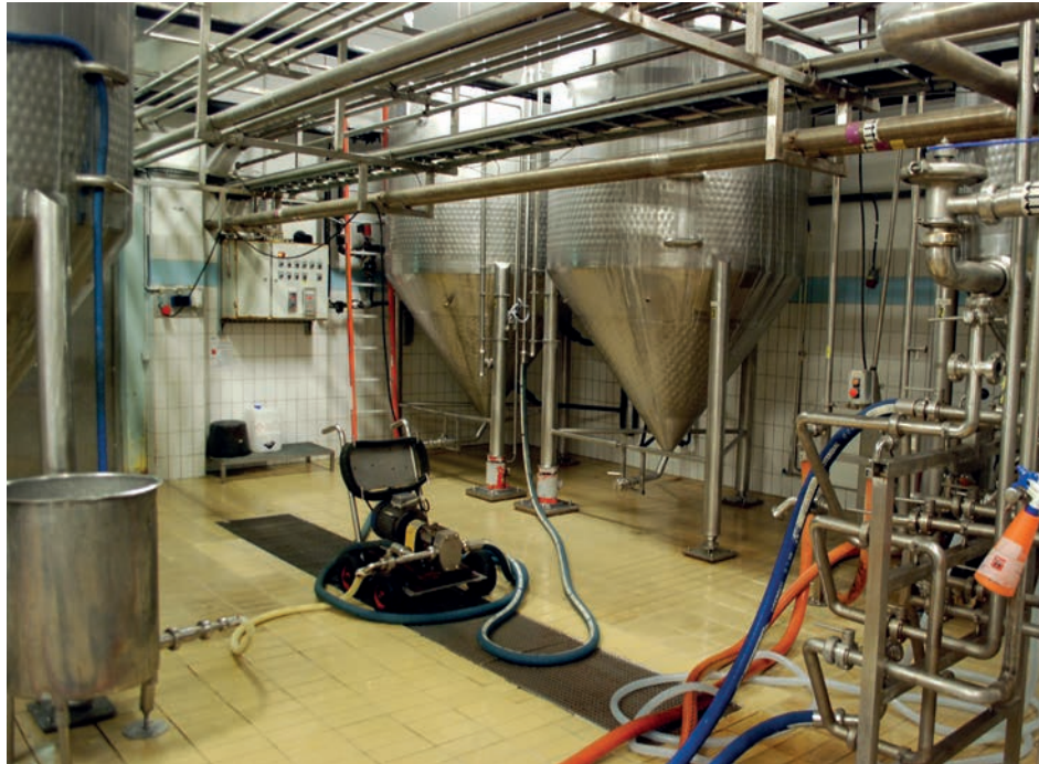
I jästrummet finns också sex tankar där jäst från jäs- och lagertankar kan förvaras i väntan på återanvändning. Det dominerande materialet är, liksom nästan överallt i bryggeriet, rostfritt stål. Jästtankarna har en cylinderkonisk form som underlättar uttagandet av jästen. På bilden syns två av tankarna. Från jästrummet kopplas jästen direkt in i vörtstammen med hjälp av slangar och detta område skymtar i bildens högra del. Foto LKU.
