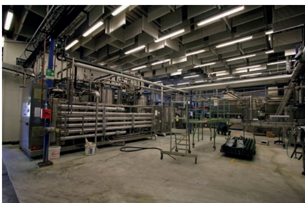
Den aseptiska linjen. Till vänster i bild syns en anläggning med horisontella metallrör. Bakom dessa finns tre tankar varav de två längst till vänster användes för pastörisering och den till höger tillhörde CIP-anläggningen (rengöring). Längs med den bortre väggen står tappmaskinen. Foto HL.
