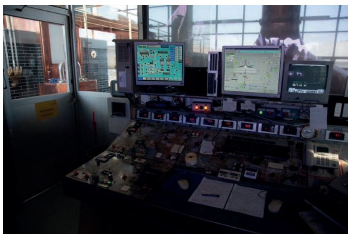
När bryggeriet togs i drift i början av 1960-talet representerade denna kontrollpanel höjden av modernitet och något att vara stolt över. Panelen skulle egentligen ha suttit vänt åt andra hållet, men när det visade sig att den var bättre synlig från bilvägen utanför bryggeriet om den spegelvändes så fick det bli så. Kontrollpanelen används än idag. Vårby Bryggeri är inte fullt ut automatiserat och utrustat med central driftstyrning. Istället styrs driften från flera platser i bryggeriet och dessutom är en hel del manuella moment nödvändiga. Foto JB.
