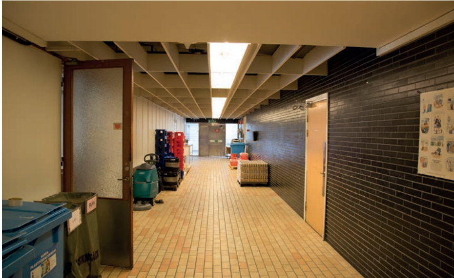
Korridor i anslutning till den före detta matsalen. Undertak, tegelklädda väggar och sandfärgat tegelgolv är här bevarade. Bild nr Idng20130621h. Foto JB.
