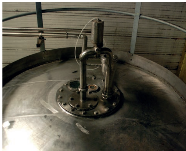
På trycktankarnas ovansida finns utrustning för tillförsel av kolsyra, luft, rengöringsmedel och ventilation. Röret till vänster i bild används för så kallad CIP-ning (se även kapitlet om rengöring). Inne i tanken, nära locket, finns en sprayboll som är en roterande kula. Vid CIP-ning sprutas rengöringsmedlet ut ur den roterande spraybollen och gör rent i hela tanken. Det högra röret är till för luft eller kolsyra. Foto LKU.
