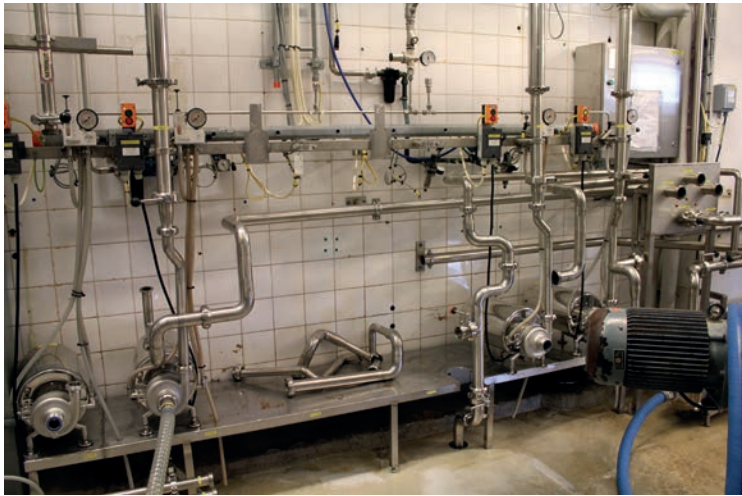
Rör som går till Mixer 1, 3 eller 4 samt från cidertanken. Det vänstra röret går till Mixer 1, det andra röret (som kommer upp genom golvet) kommer från cidertanken, nästa rör går till Mixer 3 och det fjärde röret går till Mixer 4. Foto HL.
