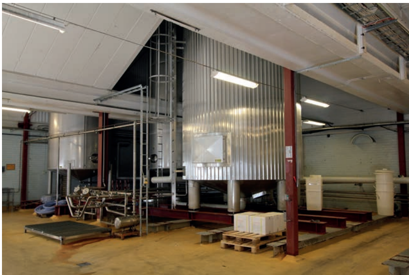
Tankar för sockerlag längst till vänster i bilden. I förgrunden syns glukostanken (druvsocker) i veckad plåt. Den slutade användas januari 2012. Framför tankarna syns en del rör som sticker ut, det är panelen för transport av sockerlagen till beredningen. Foto HL.
