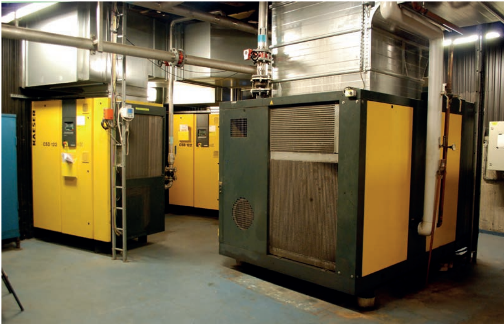
I tryckluftscentralen finns ett antal kompressorer som producerar tryckluft till bryggeriet. Användningsområdena är många, exempelvis för transport, som drivkraft för arbetsmaskiner och som styrmedium i regler- och automatiseringsprocesser. Tryckluft används också till alla ventiler. Foto LKU.
