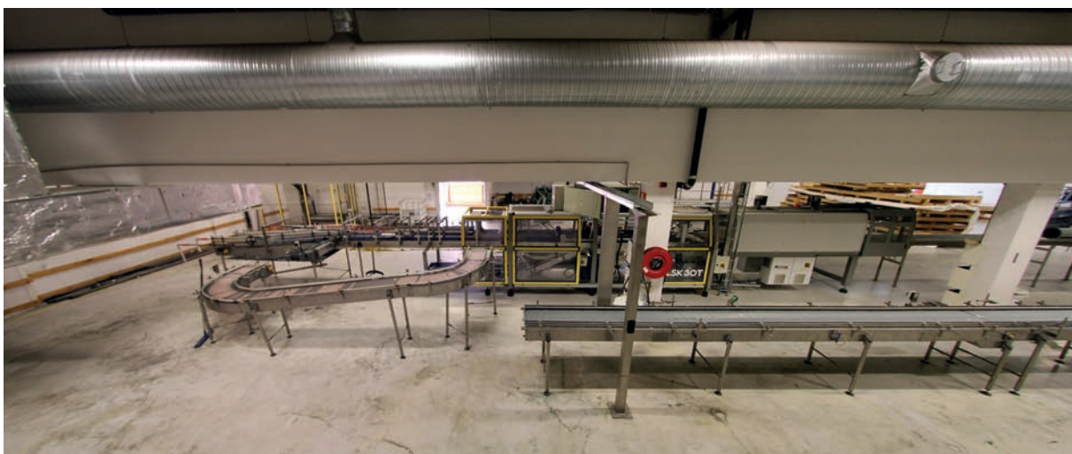
ÅPET-linjen. Maskinerna som syns på bild är förpackningsmaskinen till vänster (med gula detaljer) samt till höger om den, ugnen som smälte ihop plasten runt flaskorna. Foto HL.
