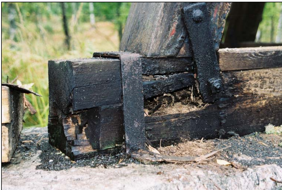
Fig 2. Bildbeteckning: Lp20030126. Syllstock före restaureringen.
