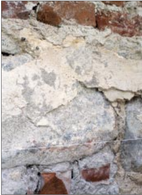
Fig 9. Bildbeteckning: Id20020054b. Spår av äldre putslager i sakristians östra fasad. Observera tegelstenarna längst ner i bilden vilka troligen är spår efter ett igenmurat ursprungligt bombål. Foto: Elisabeth Boogh.
