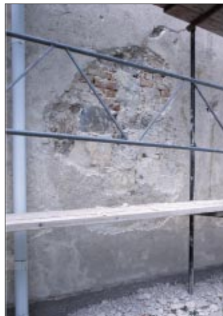
Fig 5. Bildbeteckning: Id20020053b. Igenmurningar i långhusets södra fasad (förmodat lagningsarbete). Foto: Elisabeth Boogh.
