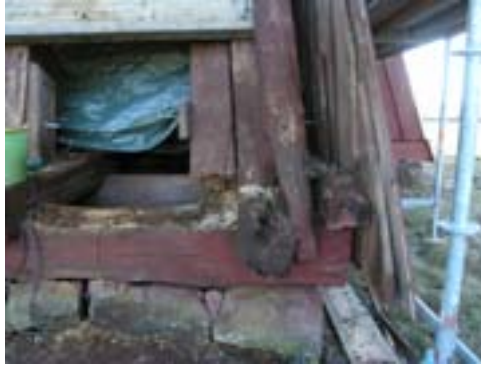
När panelen borttagits på norra fasaden kunde omfattande skador konstateras i syllstock och golvbjälklag. Bildbeteckning: lp20040265. Foto: Kersti Lilja 2004.
