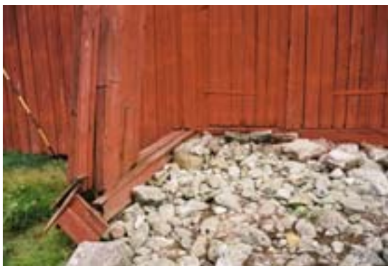
Snedsträva och stenuplag före arbetena. Bildbeteckning: lp20040262. Foto: Kersti Lilja.
