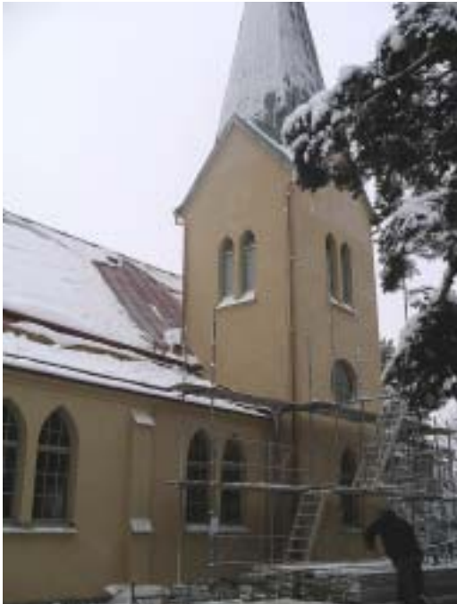
Kyrkan efter utförd renovering, då den återfått slätputs och ursprunglig kulör. Bild lp20040314
