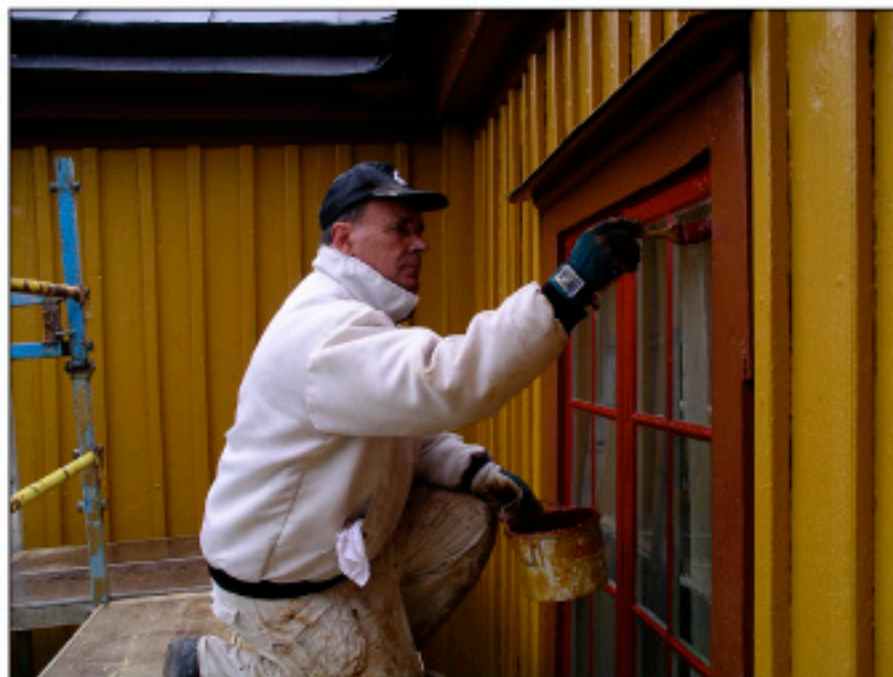
Imålning av gångjärn efter att fönsterbågarna satts tillbaka, norra fasaden. Foto: Kersti Lilja, juni 2004.
