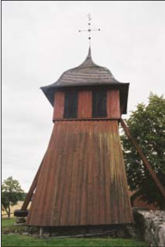
Bildbeteckning: lp20040122. Husby-Ärlinghundra klockstapel före restaureringen. Lutande fasadparti mot norr Foto: Kersti Lilja.
