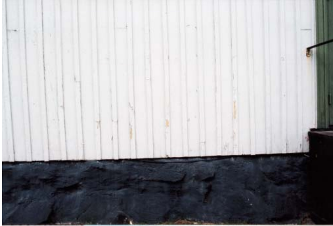
Detaljbild av kyrkans locklistpanel före restaureringen. 1950-talets gula fasadfärg syns under den flagnande vitgråa alkydoljefärgen. Foto: Kersti Lilja juni 2003.
