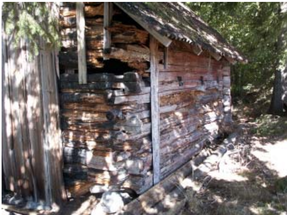
Del av bodens södergavel, med en äldre brandskada, och östra långsidan. Bild lp20040305
