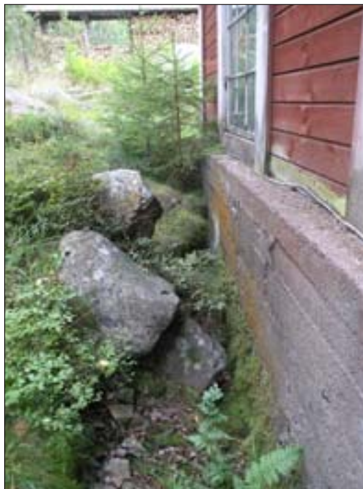
Fig 58. Gjuten sockel mot norr med sprickor och mosspåväxt. Foto: Kersti Lilja 2005. Bildbeteckning: Lp2005-0889.
