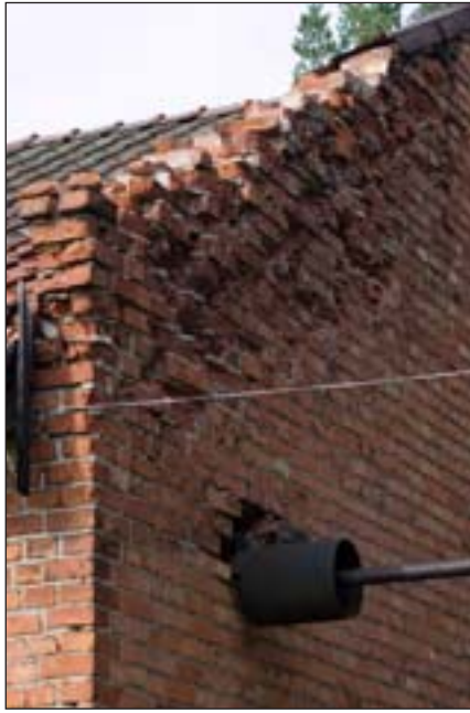
Fig 52. Skador i murverket på gavelröset, smedjan, buskropp A. Foto: Mattias Ek 2005. Bildbeteckning: Lx2005-1580.
