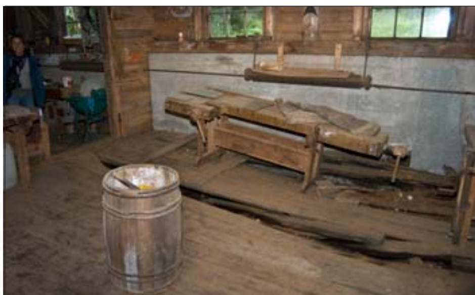
Fig 59. Golvet i bottenvåningens östra rum har skadats av fukt och läckage. Foto: Mattias Ek 2005. Bildbeteckning: Lx2005-1595.
