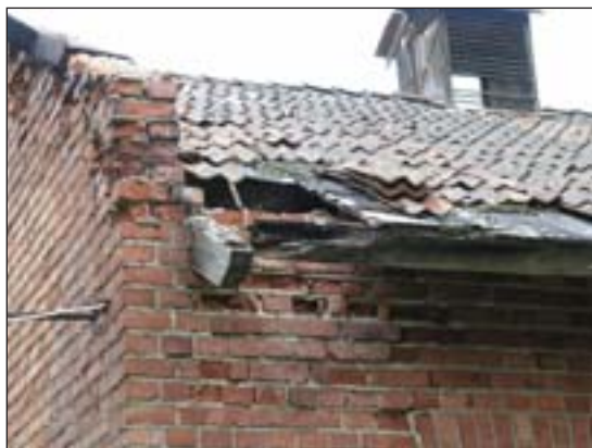
Fig 54. Skador på taket, norra takfallet, smedjan, buskropp A. Tegelpannor saknas liksom läkt, papp och undertak. Foto: Kersti Lilja 2005. Bildbeteckning: Lp2005-0891.
