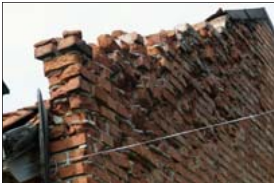
Fig 53. Skador i murverket på gavelröset, smedjan, buskropp A. Foto: Mattias Ek 2005. Bildbeteckning: Lx2005-1579.
