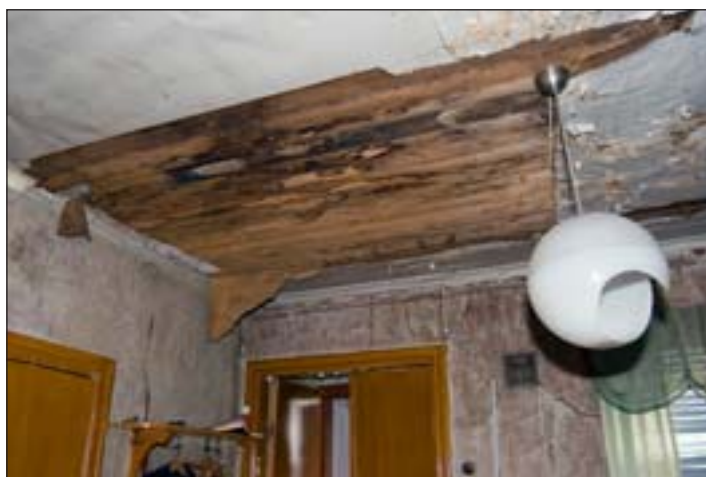
Fig 61. Fuktskadat papptak och brädtak i rum 2. Foto: Mattias Ek 2005. Bildbeteckning: Lx2005-1584.
