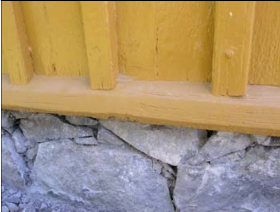
Detalj av sockeln efter att cementbruket borttagits. Foto: Kersti Lilja 2005. Bildbeteckning: Lp2005-0898.
