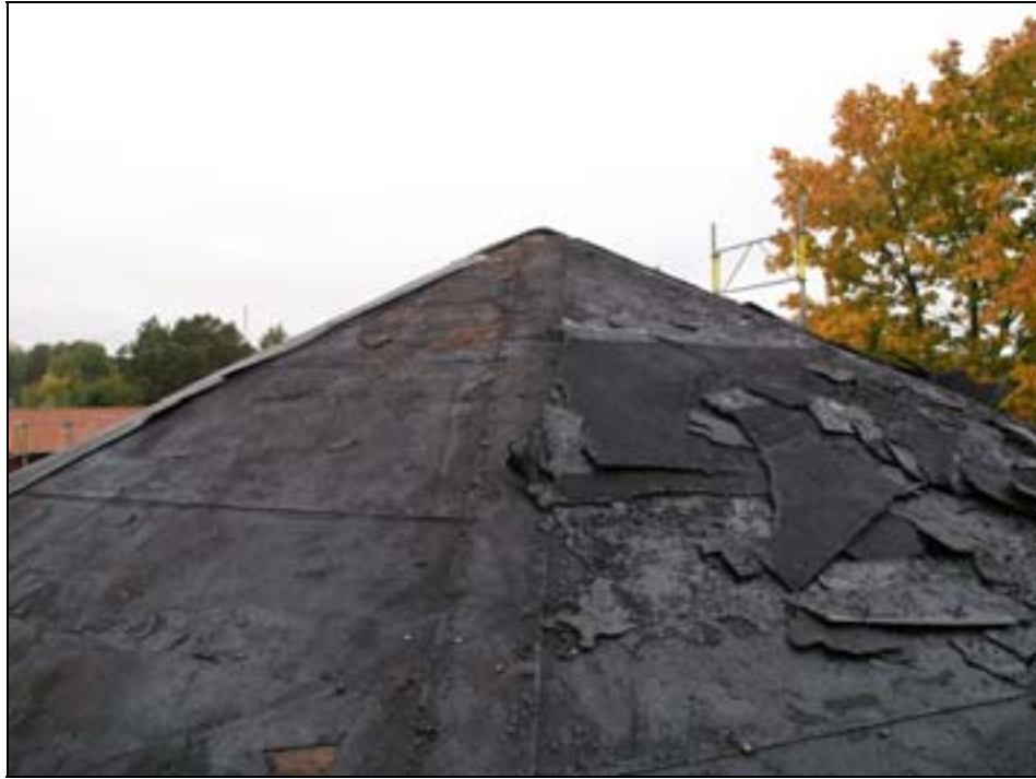
Bildbeteckning: Lp2005-0951. Äldre takpapp på kapellets östra putsade del. Foto: Kersti Lilja 2005.
