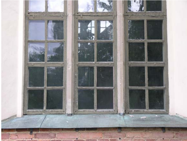
Fönster innan renovering. Foto: Lisa Sundström, juni 2005.
