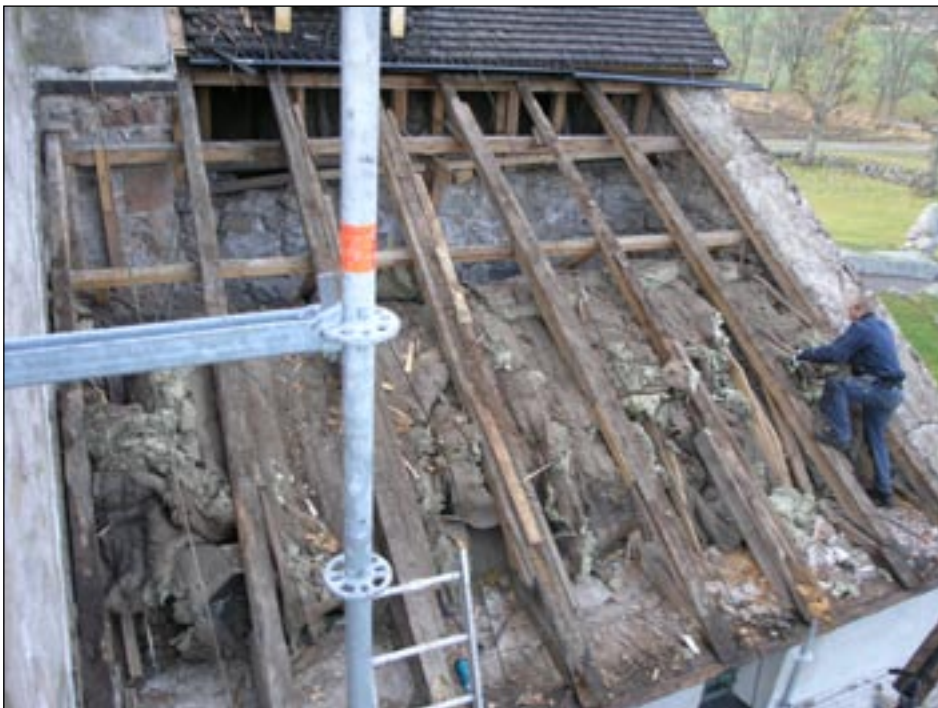
Bildbeteckning: lp2005-1473. Sakristians takkonstruktion med rötskador. Foto Kersti Lilja 2005.
