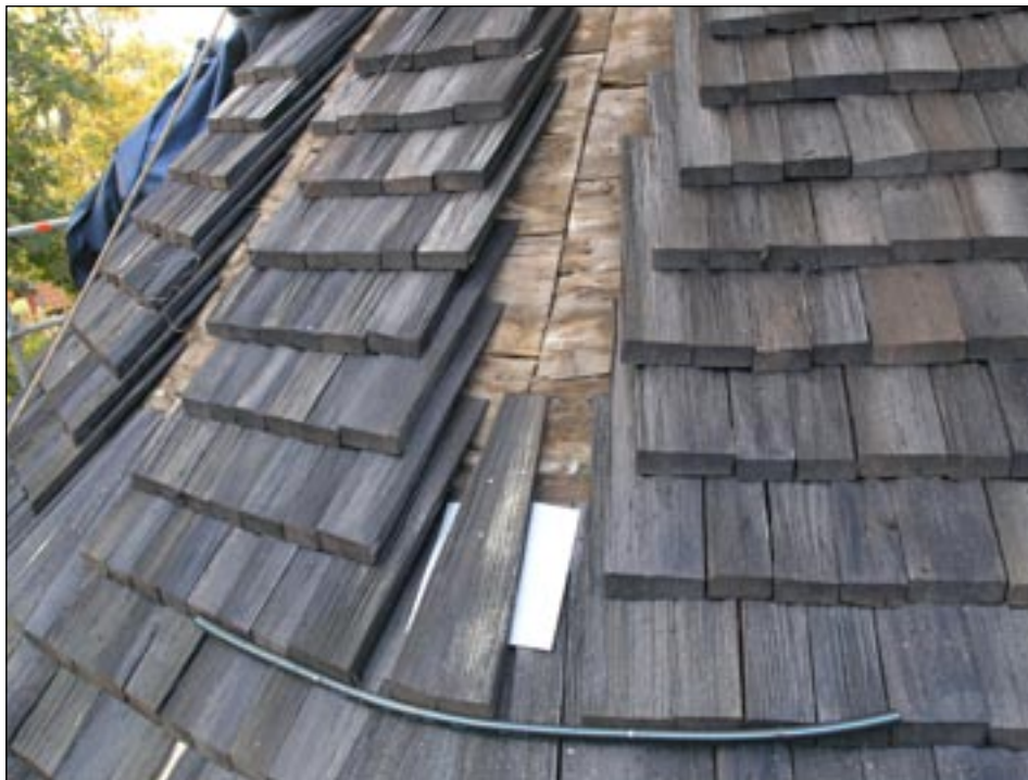
Bildbeteckning: lp2005-1471. Detaljbild under arbetena med spåntäckning av kortaket. Foto Kersti Lilja 2005.
