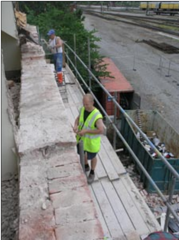
Rivning och dokumentation av stationsbyggnaden. Bilden tagen från nordost. Bildbeteckning: lp200514-93. Foto: Kersti Lilja 2006.
