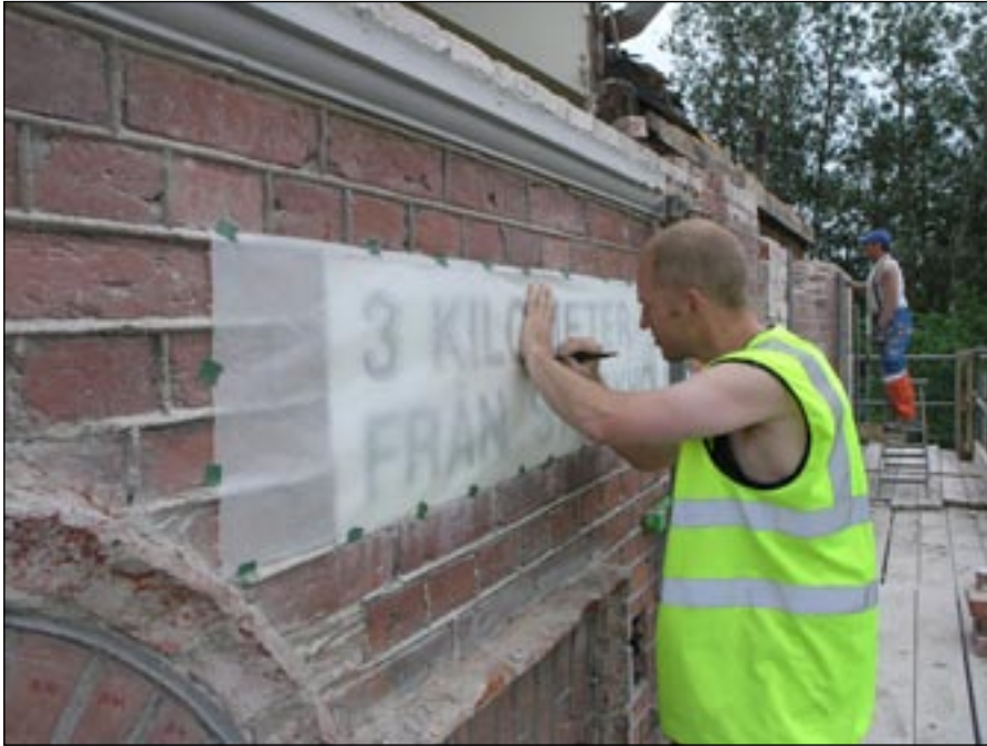
Tomas Englund, Rivcenter i Sverige AB kalkerar av murad skylt på västra fasaden före rivningen. Bildbeteckning: lp200514-92. Foto: Kersti Lilja 2006.
