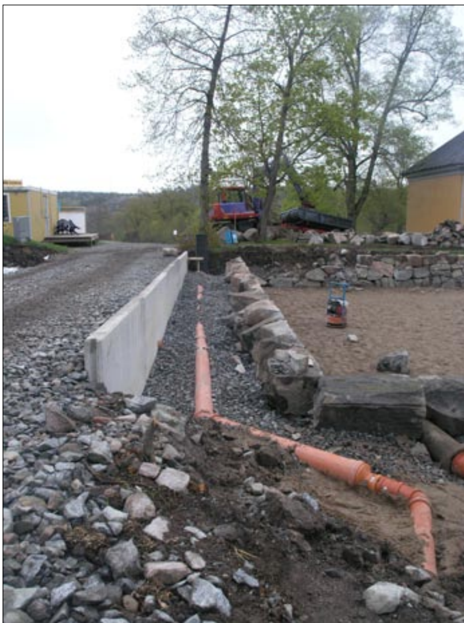
L-stöd av betong vid vägen intill dammens västra kortsida. Foto: L. Sundström. Bildnr: lp20060372
